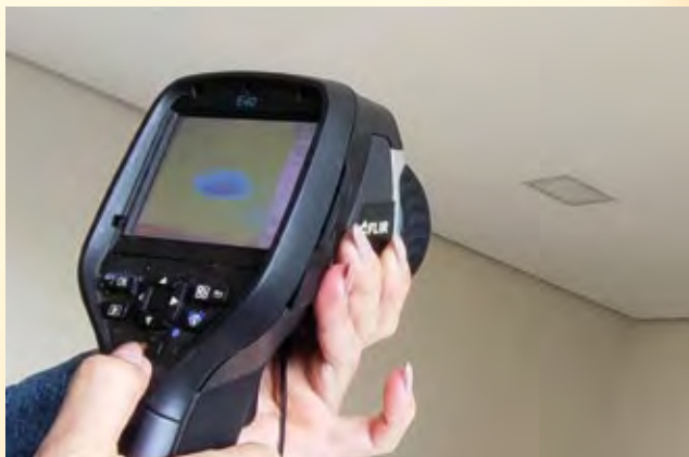
Figura 4 - Inspeção termográfica infravermelha evidenciando indicativo de umidade oculto em forro
