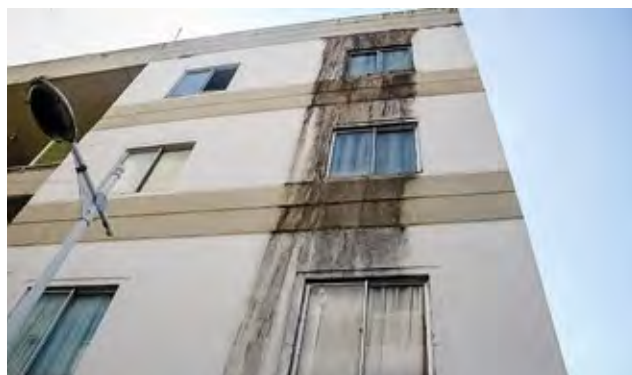
Figura 4: Presença de mofo em fachada
