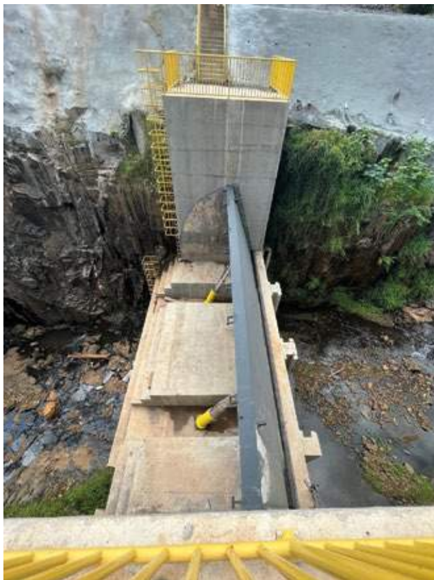
Figura 3 - Comporta instalada no emboque. Imagem: Schneider Engenharia.
