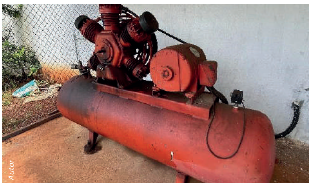
Figura 3 – Inspeção extraordinária. Equipamento parado por mais de 12 meses
