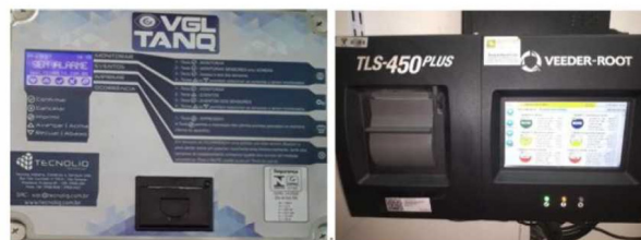
Figura 2 - Consoles das centrais de monitoramento ambiental
