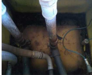
Figura 4 - Sump de filtro de óleo diesel (esq.) e sump de bomba de abastecimento (dir.)
