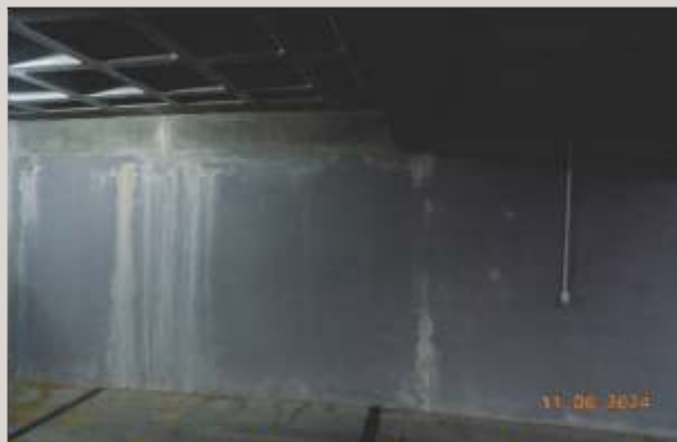
Atuação da água em parede de garagem e encostada com o solo (lado exposto) – sem tratamento de impermeabilização.
