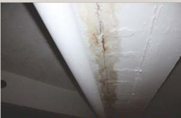
Falhas de tratamento em juntas de dilatação superficialmente expostas a chuvas.
