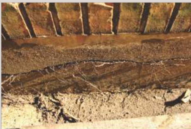
Ação de raízes sobre a impermeabilização de floreiras devido a falhas de estudo técnico prévio.
