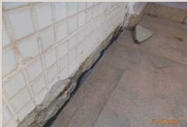
Ausência de arremates para subida da impermeabilização. Ausência de tratamento de juntas de encontro.
