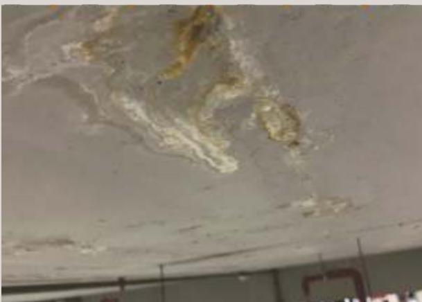
Água passando pela laje e promovendo degradação do concreto e armaduras devido a falhas de especificação de impermeabilização.
