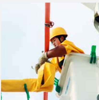
Engenheiras trabalham em sistemas elétricos de alta tensão. © Sociedade Chinesa de Engenharia Elétrica
